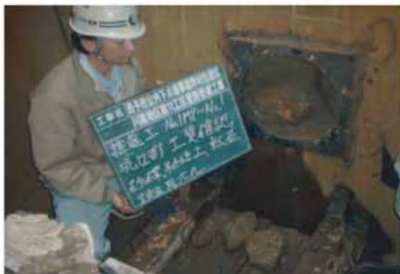
発進部の転石状況
